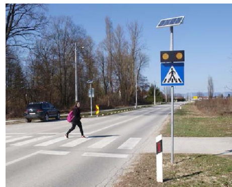
postavljen u solarnoj izvedbi
