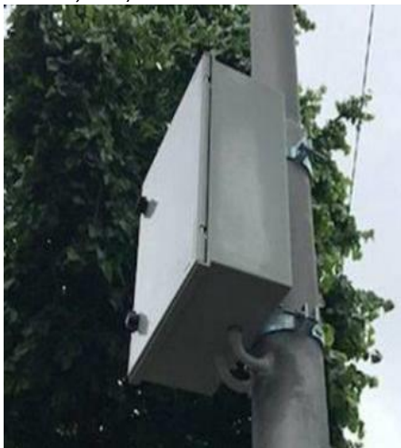
Primjer postavljanja razvodnog ormarića
